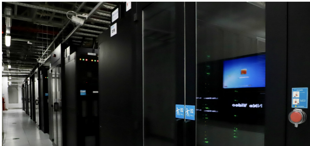
广西五象 IDC 数据中心
